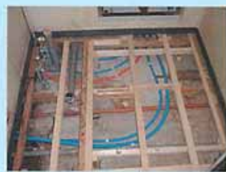
室内は工事しやすいサヤ管ヘッダー方式へ（参考写真）
