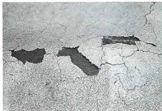
防水層の破断状況
