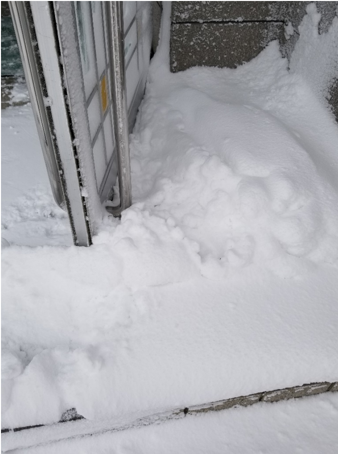
写真① ※積雪抵抗で開ききらず途中で停まり、 機能停止状態。
